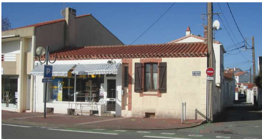
Fig. 78. 2 Bd Egalité, dégradation de la façade
