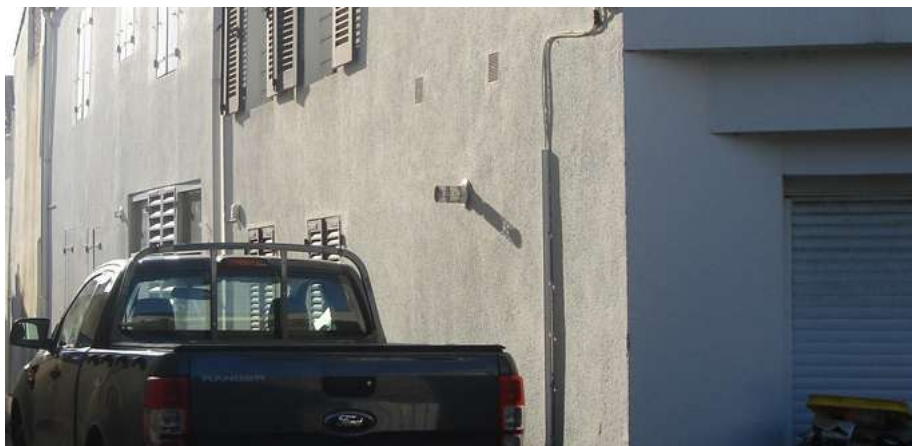
Fig. 83. Rue du Marché, ventouse visible de l'espace public
