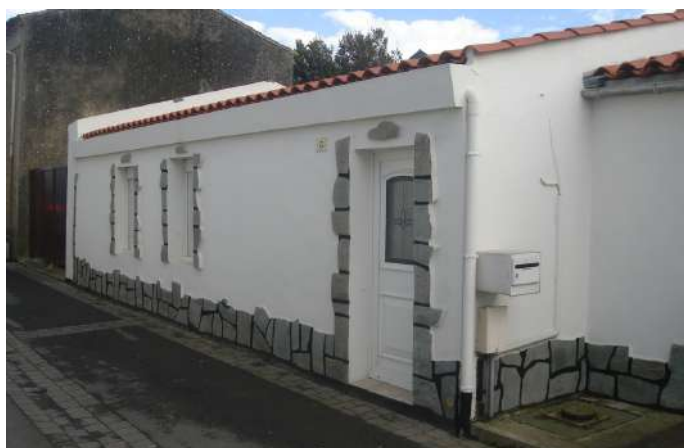
Fig. 79. 3 rue du Puits Servanteau, soubassement inadapté
